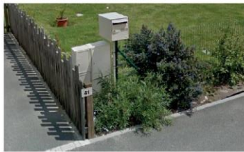
Intégration des coffrets techniques dans la haie
